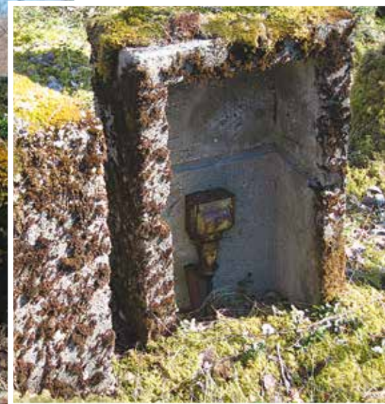
Kabelpunkt for samband, luftskyttsstilling 3 i Nes. Like ved ligger en deknings-og ammunisjonsbunker i dårlig forfatning. N67°28.626' E015°28.550'. FOTO: TG.
