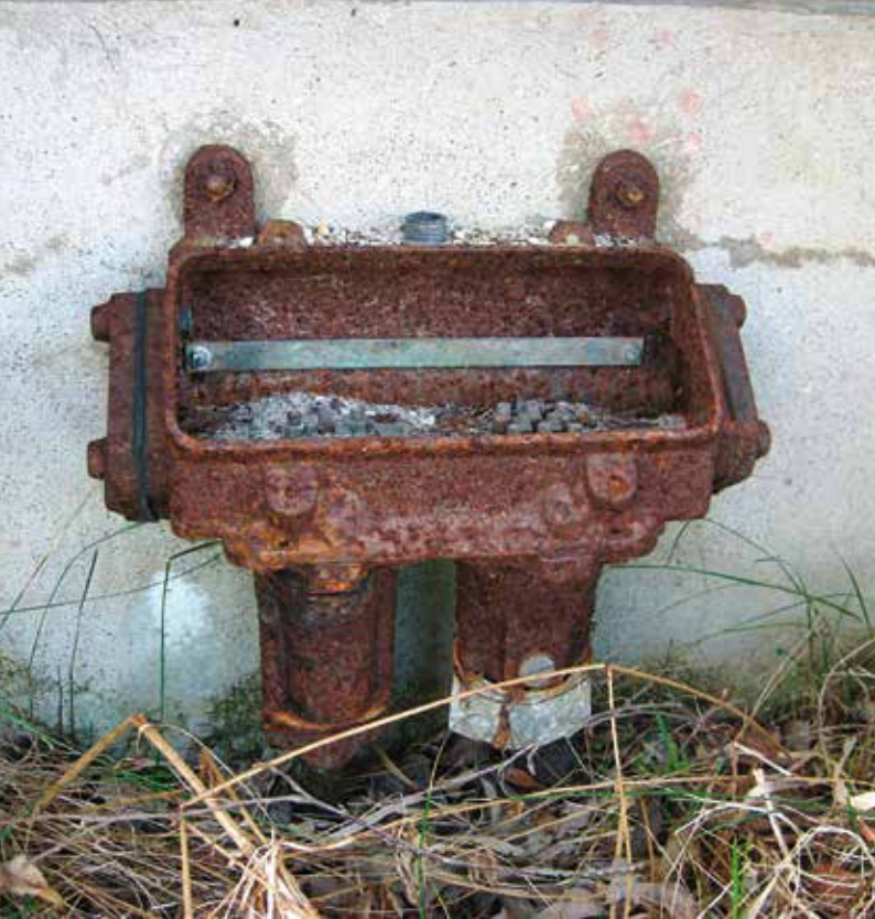
Rester av elektrisk installasjon for å dreie kanonen. Foto: TG.
